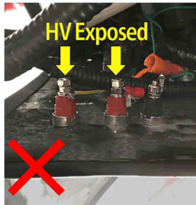
HV 露出 HV Exposed
